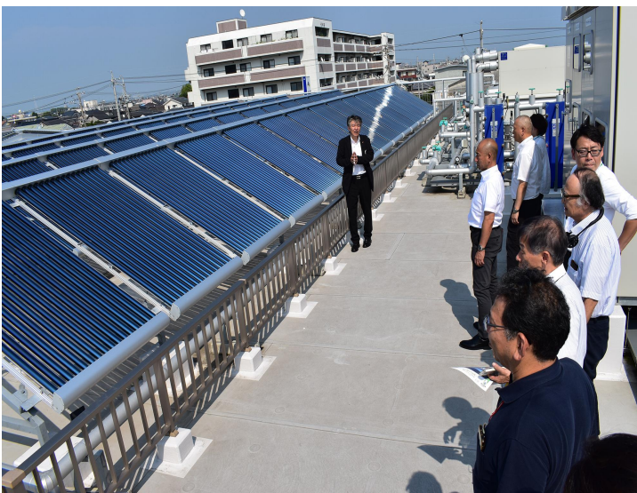
太陽熱集熱装置
